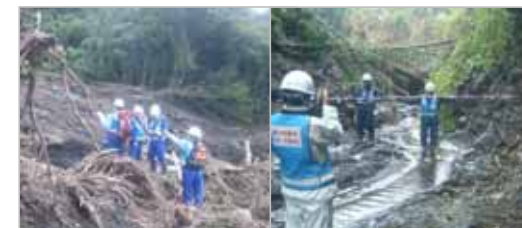
緊急点検状況 (H25年伊豆大島災害)
